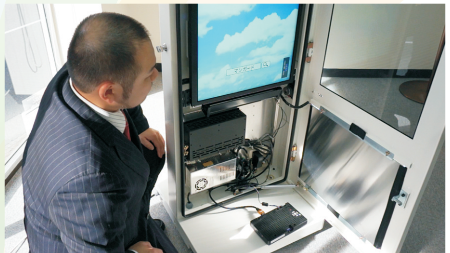
LK320TKGの内部を開けて動画プレーヤーを接続している様子 写真の機体は特注品のため、表面材質・カラーリングが異なります。
